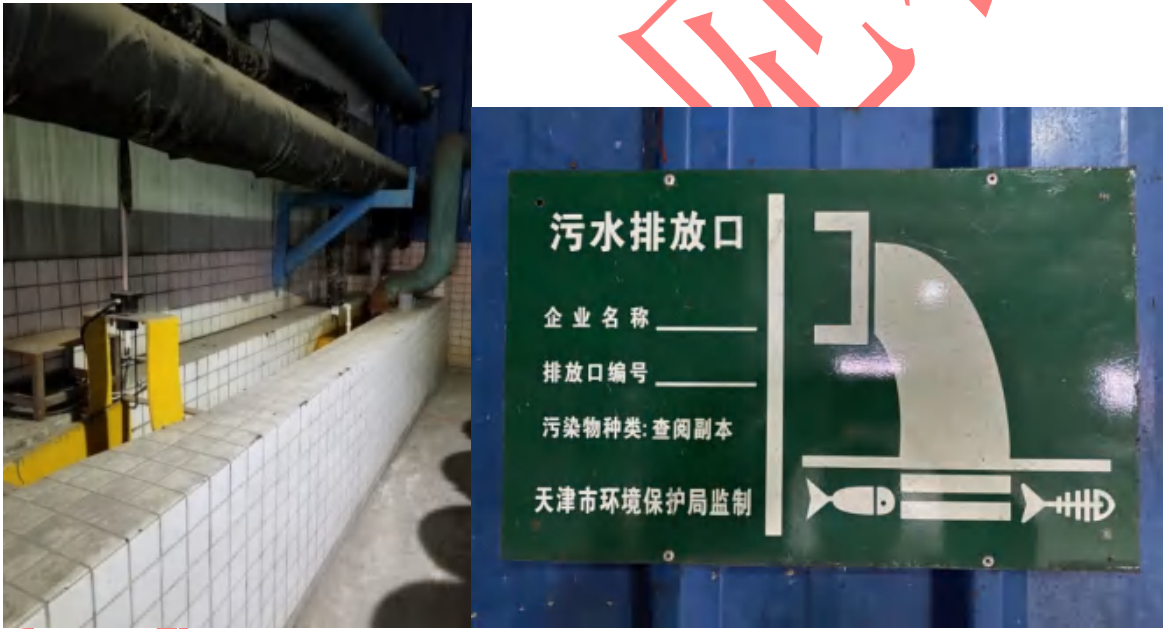
图 8.2-4 废水总排口规范化设置
