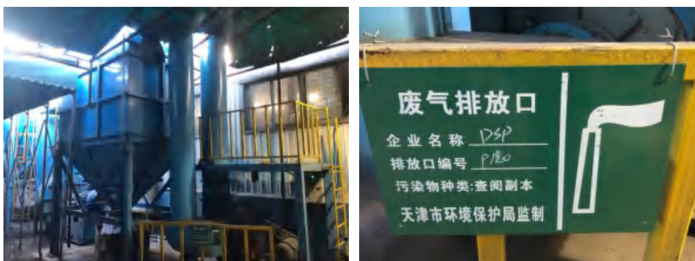
图 9.2-3 DA041 排气筒规范化设置
