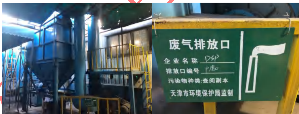
图 9.2-9 DA041 排气筒规范化设置
