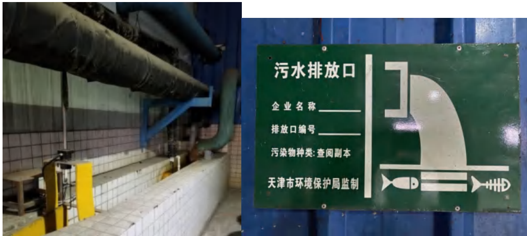
图 9.2-10 废水总排口规范化设置
